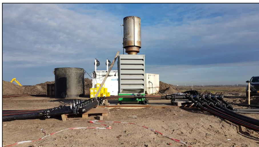
Uitbreiding stortgasonttrekking Nauerna park fase 2 met extra fakkelstation
